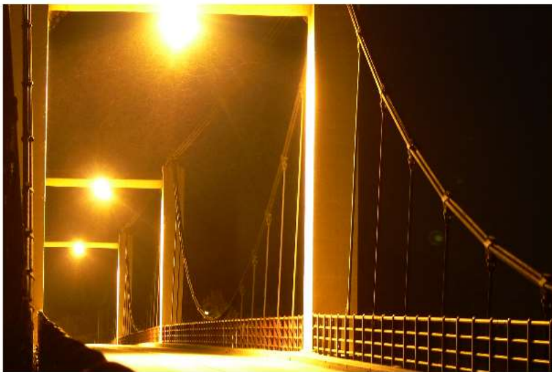
fig.8 Lampade a vapori di sodio per l'illuminazione stradale
